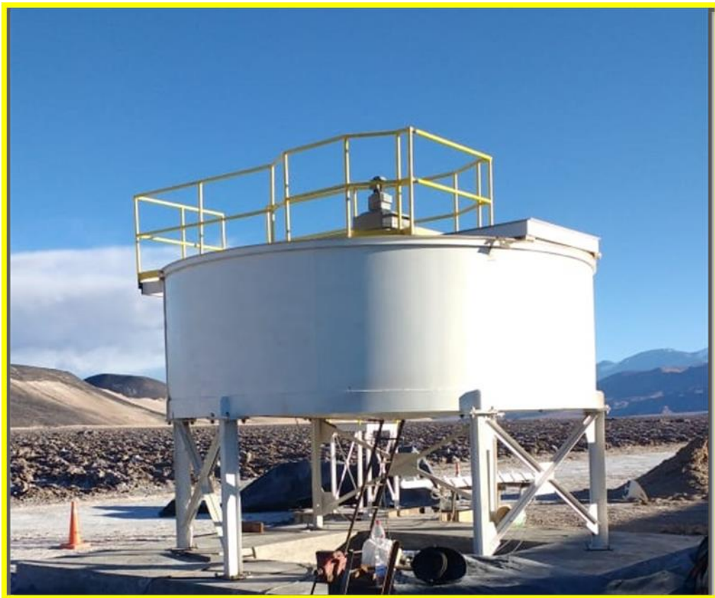
Clarificador Proyecto 3 Quebradas.
